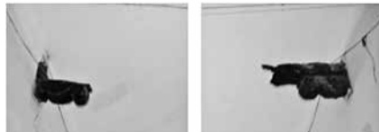
Pérdida de canes que refuerzan la estructura de la cubierta.
