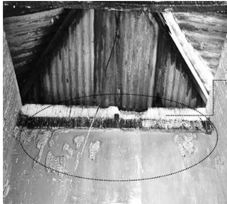
Nidos de insectos en la estructura de la cubierta de la torre campanario.
