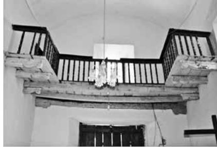
Fragilidad de la estructura del coro.
