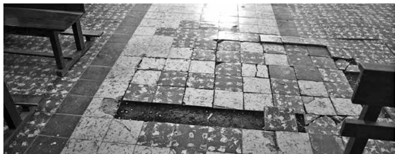
Desprendimiento del acabado de piso de la nave del Templo Señor de la Exaltación Ocobaya
