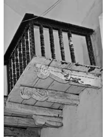
Anidamiento de termitas en el piso del coro.
