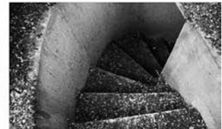
Deterioro del piso y muros.
