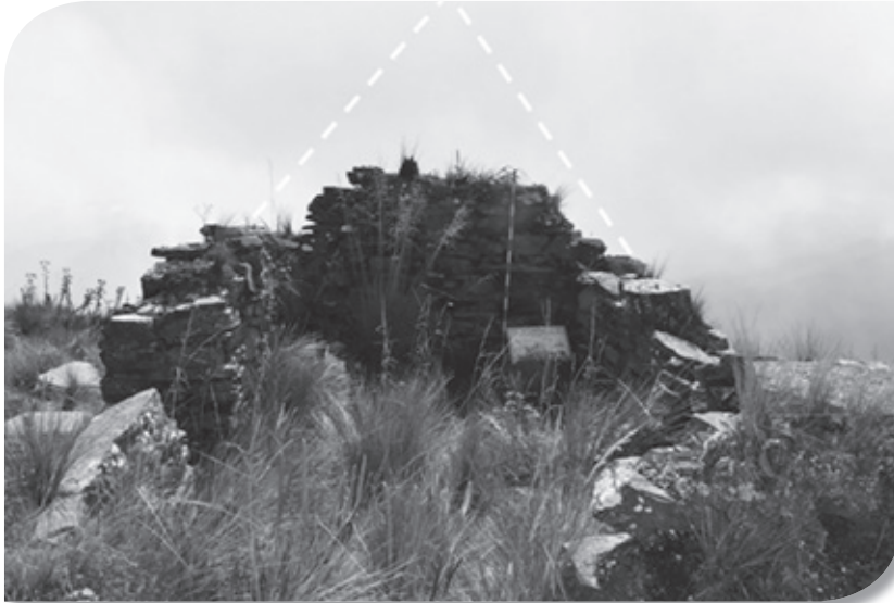
Fig. 26: Vista a una estructura con el techo de dos aguas derrumbado.
